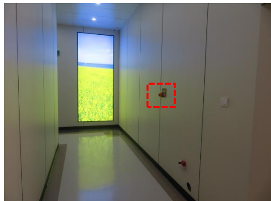
图 3-5 机房内迷道与急停按钮
