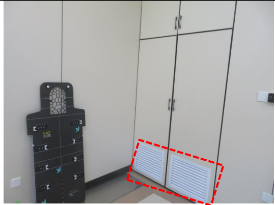
图 3-23 机房内排风口（东南角）
