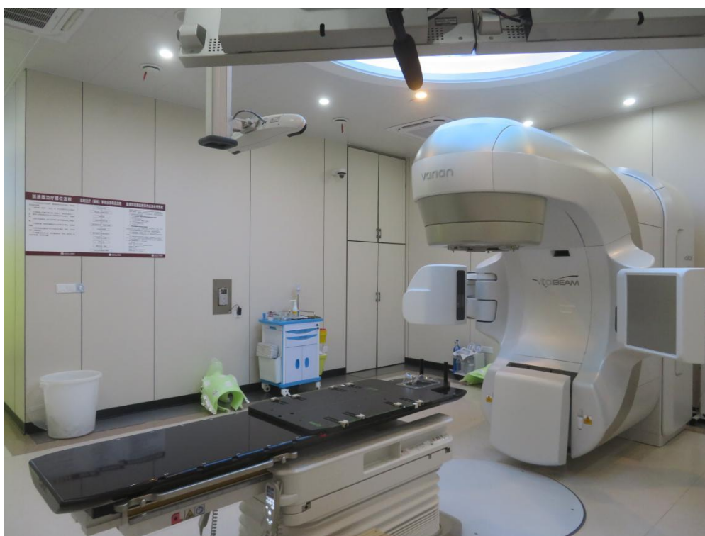
图 2-1 本项目 Vital Beam 型医用电子直线加速器
