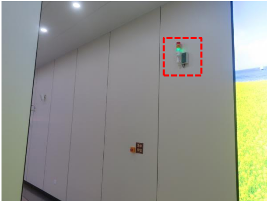
图 3-24 机房内在线监测仪探头
