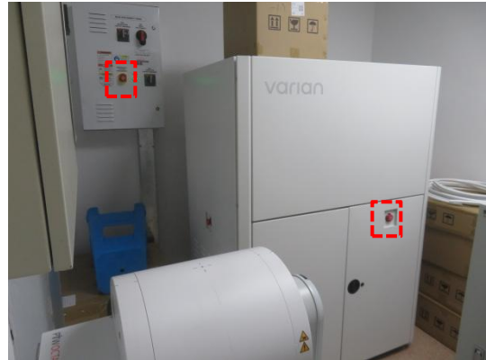
图 3-25 水冷机房内急停按钮（2个）
