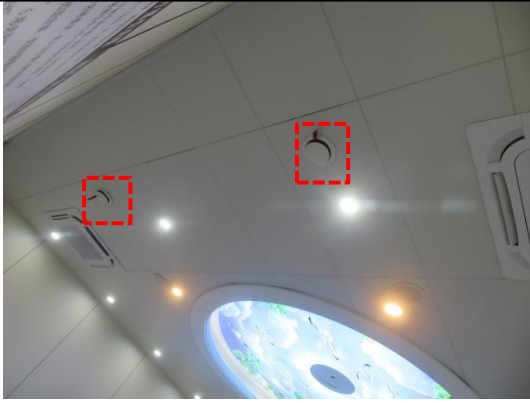
图 3-22 机房内进风口
