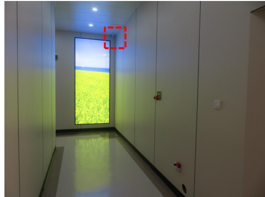
图 3-17 机房内摄像头（机房西北侧）
