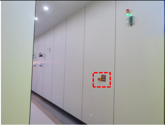
图 3-6 机房内西侧墙面急机按钮
