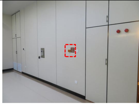
图 3-7 机房内南侧墙面急停按钮
