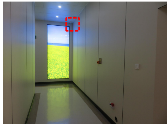
图 3-19 机房内摄像头（机房西北侧）
